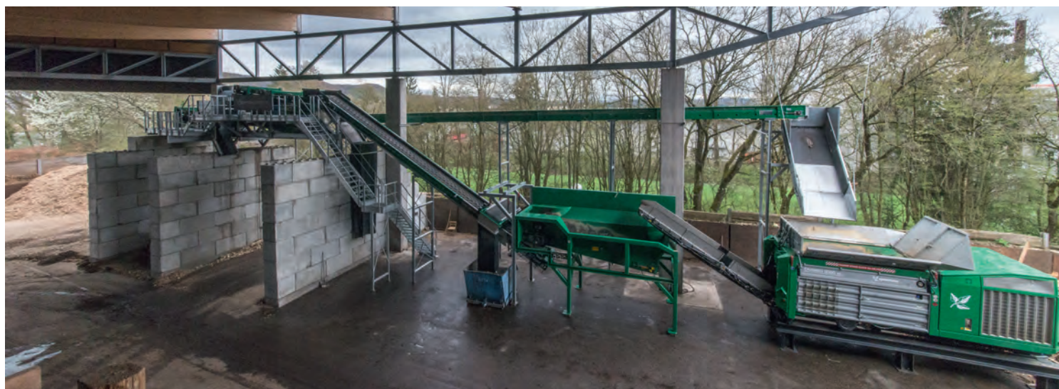
Holzaufbereitungsanlage: Crambo mit Aufgabebunker und 3-Fractionen-Sternsieberanlage.
