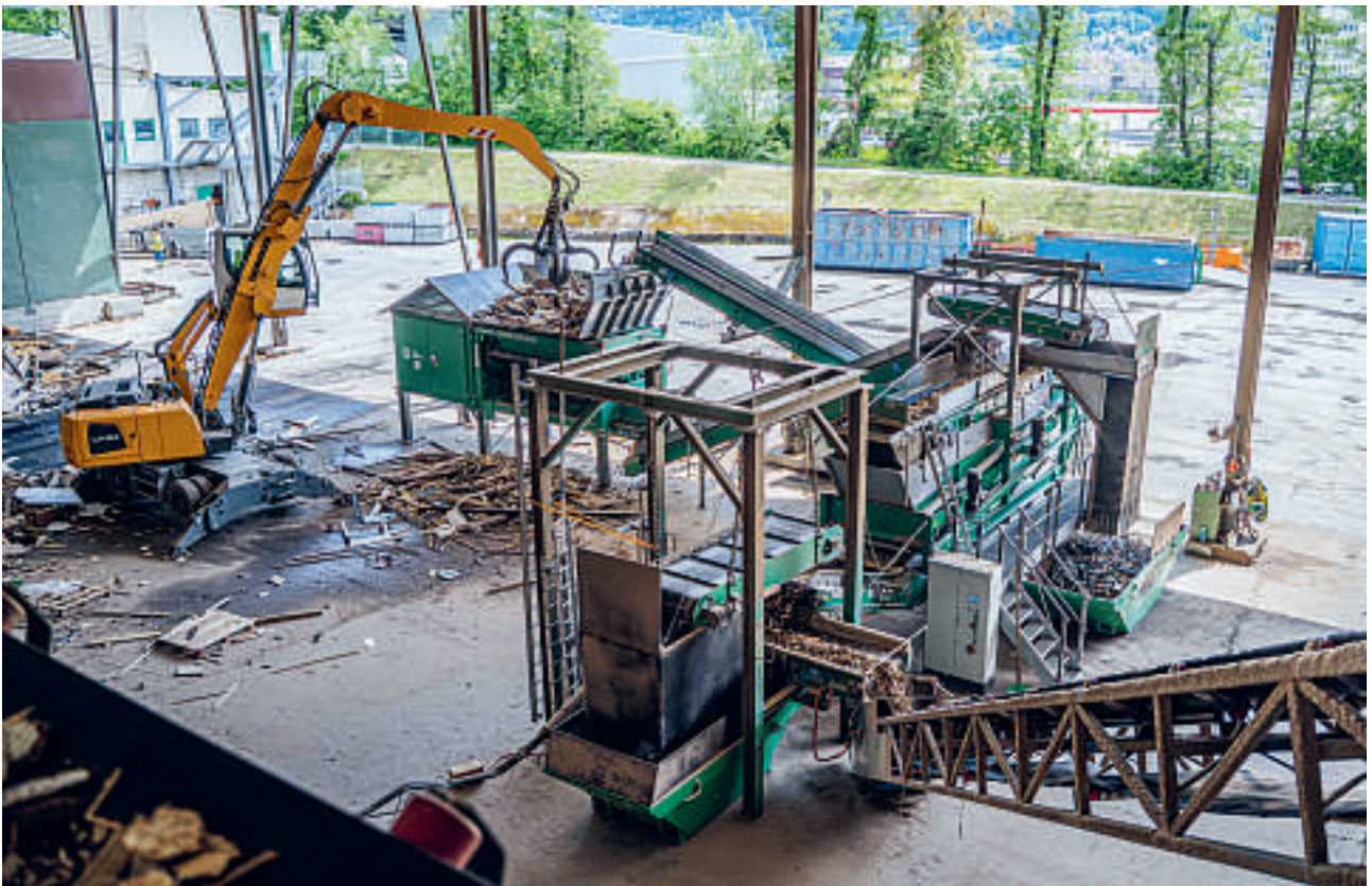
Über ein Fördersystem kann der Brennstoff auch direkt in den Vorratsbunker des Heizkraftwerks transportiert werden.
