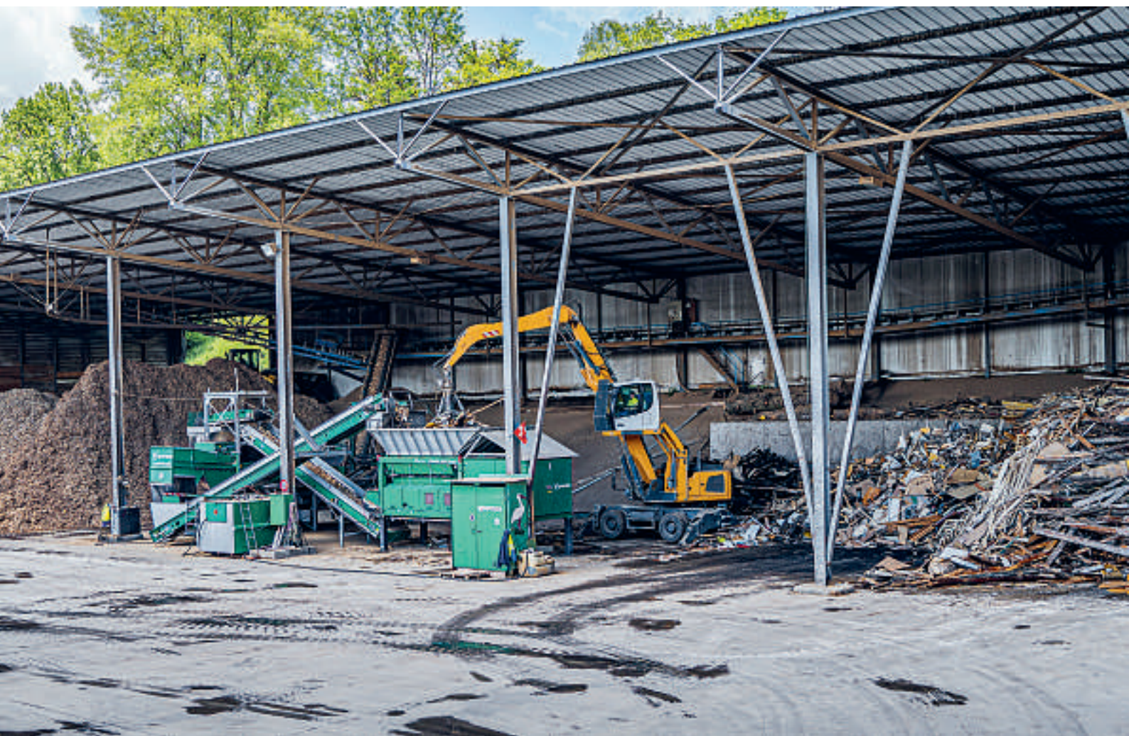
À droite le matériau de départ, à gauche le combustible fini et au centre, l'installation de traitement.
